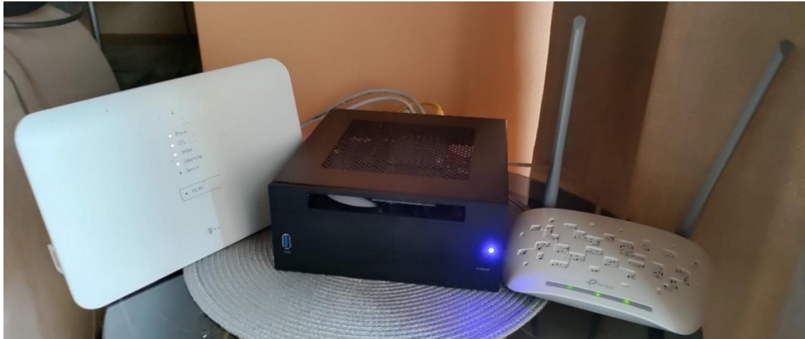
Slika 49. Uređaj Hrvatskog Telekom, pfSense usmjerivač, TP-LINK access point
