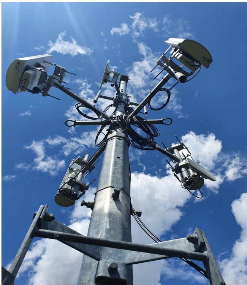
Slika 4. Prikaz stupa sa baznim stanicama Izvor: Autor
