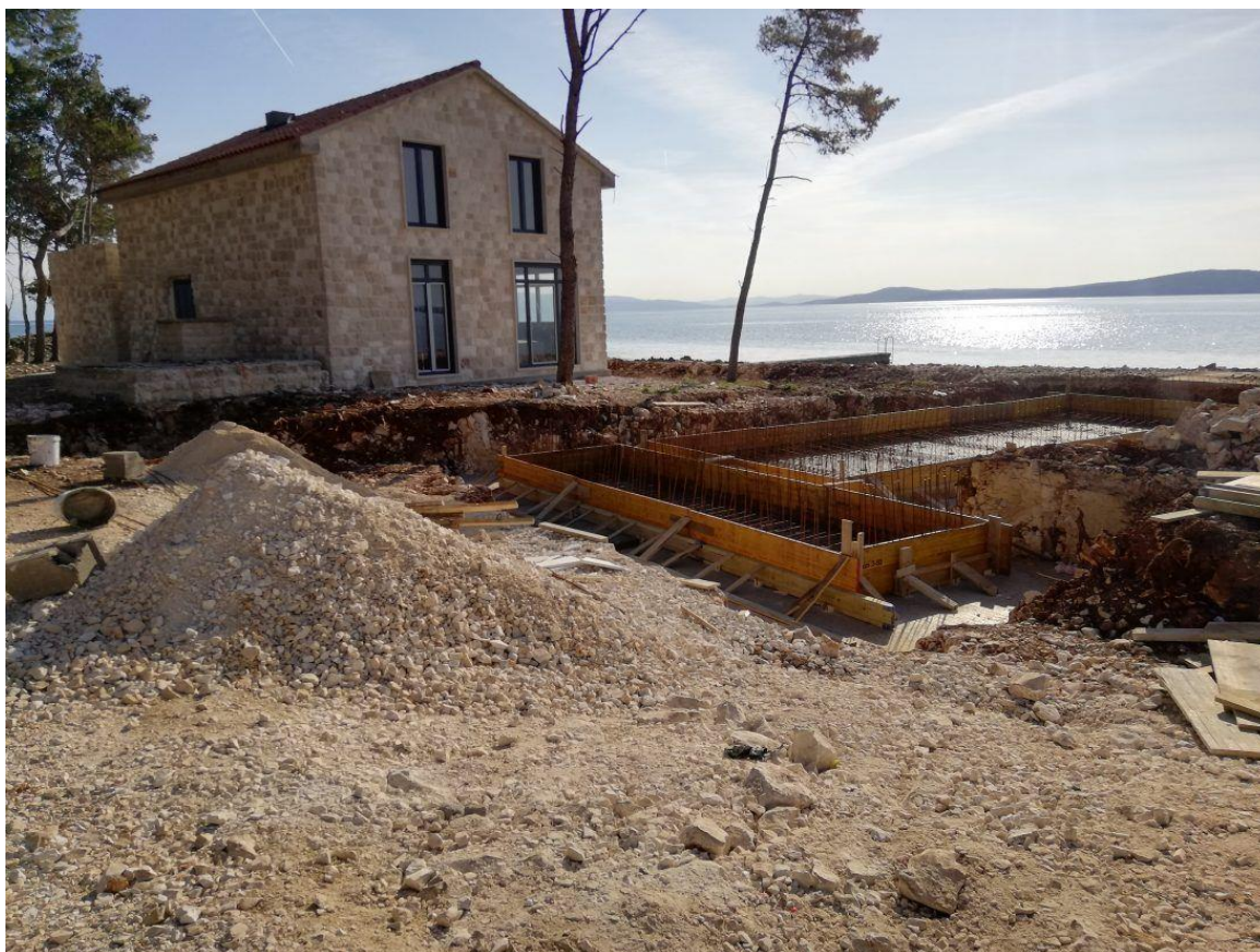
Slika 3. Bespravna gradnja na Čiovu
