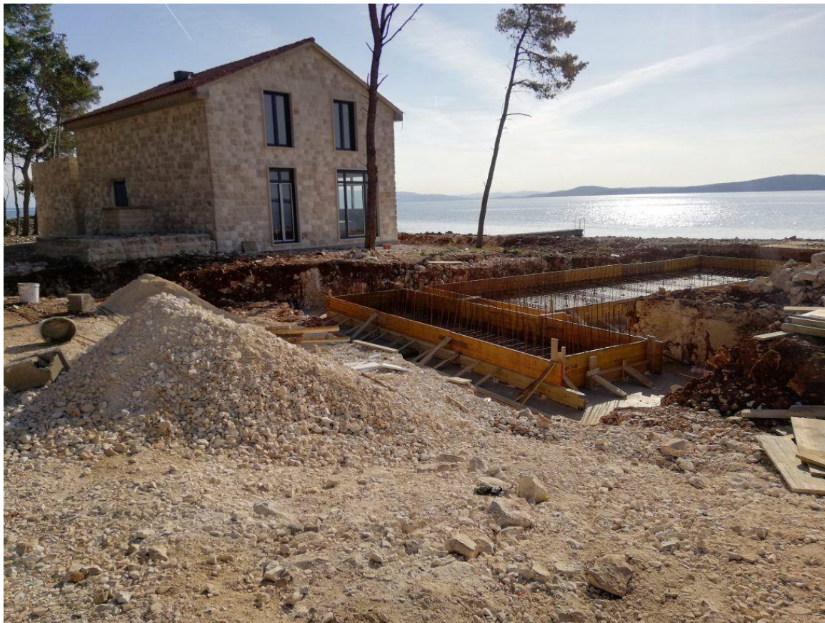
Slika 3. Bespravna gradnja na Čiovu
