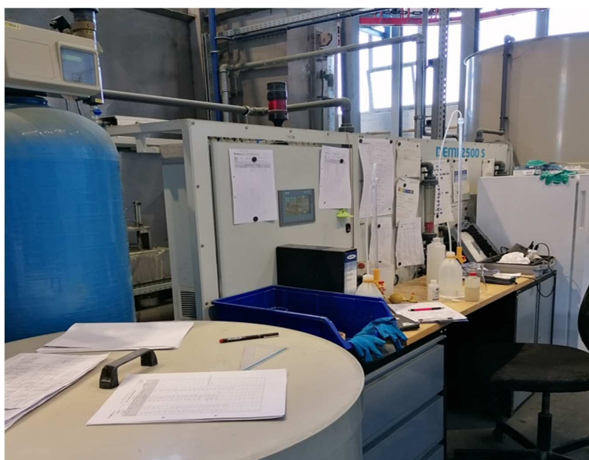
Slika 16. Postrojenje za proizvodnju demineralizirane vode
