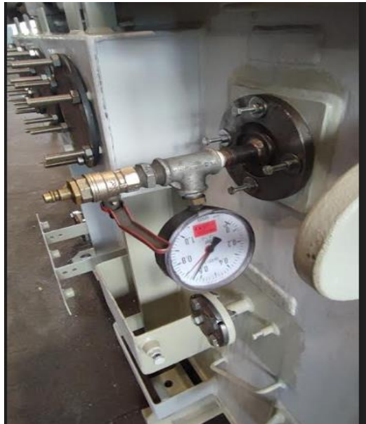
Slika 28. Zatvaranje kotla i postavljanje manometra
