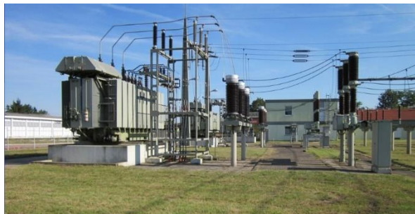
Slika 1. Transformatorski kotao u pogonskoj jedinici
