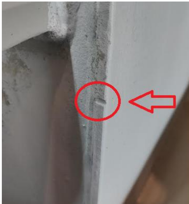
Slika 49. Oštećen materijal na kotlu
