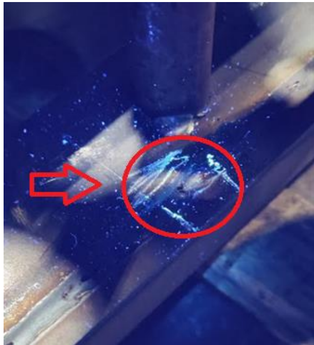
Slika 44. Treće propuštanje kotla
