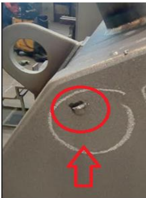
Slika 34. Čvrsti uključak na transformatorskom kotlu
