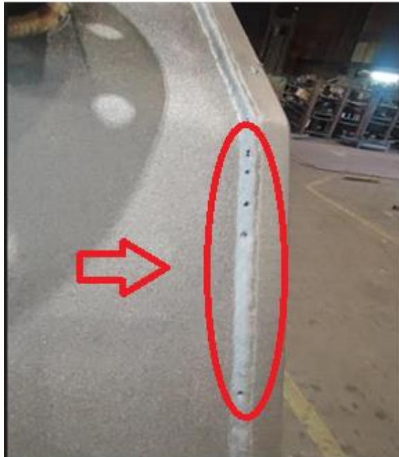
Slika 33. Šupljine na zavaru od kotla
