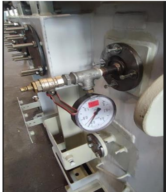
Slika 28. Zatvaranje kotla i postavljanje manometra
