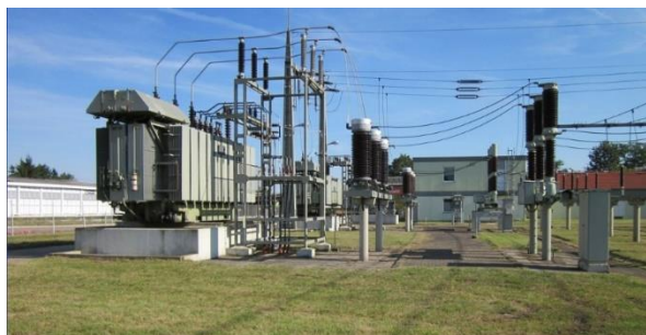
Slika 1. Transformatorski kotao u pogonskoj jedinici
