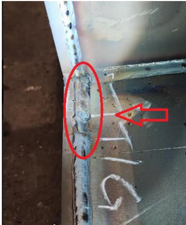
Slika 46. Izgled zavora nakon popravka TIG-om
