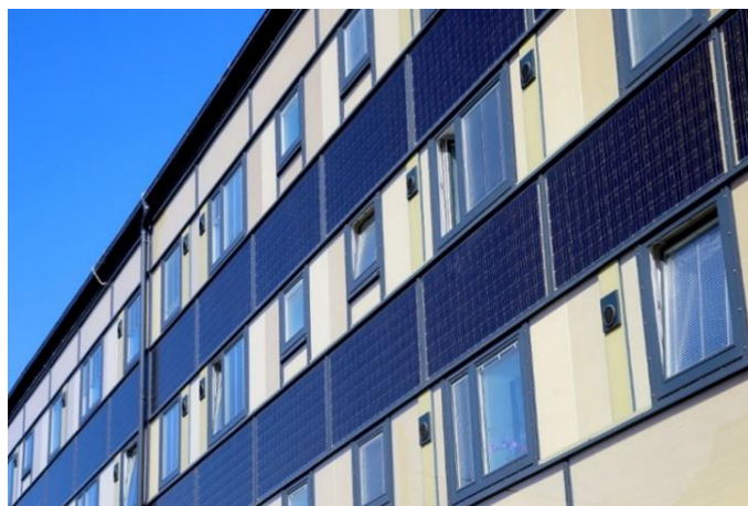
Slika 34. Solarni paneli na stambenoj zgradi uklopljeni u fasadu
