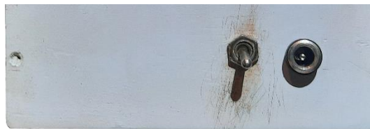
Slika 29. DC priključak i preklopni prekidač
