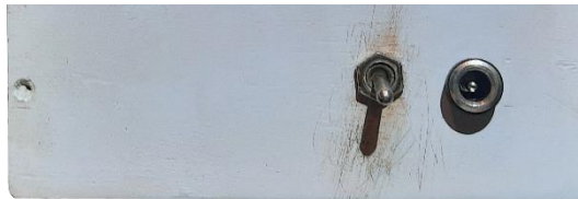
Slika 29. DC priključak i preklopni prekidač
