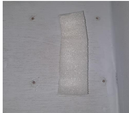
Slika 27. Rupe za pričvršćenje pumpi
