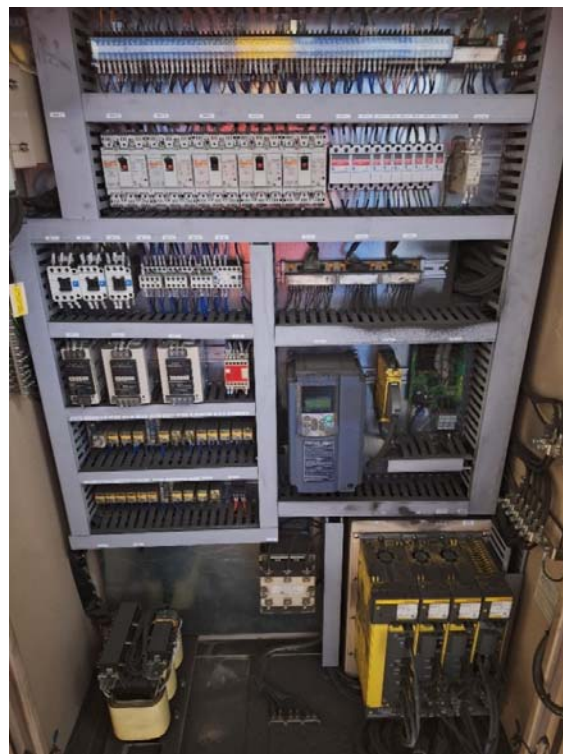
Slika 23. Elektro ormar instalacije, Ferro-Preis d.o.o.
