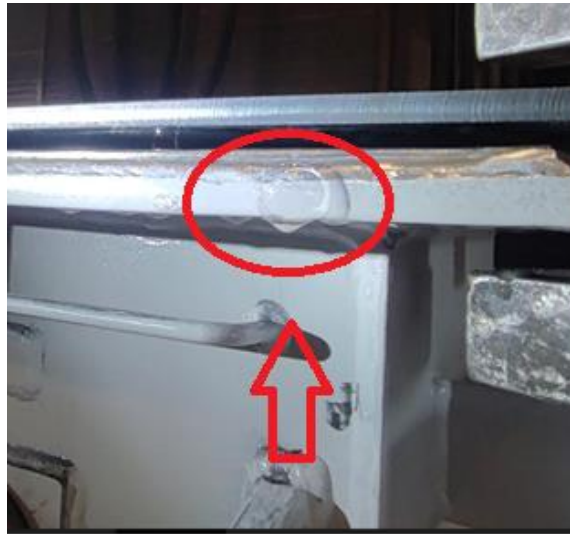
Slika 56. Prvo propuštanje kotla
