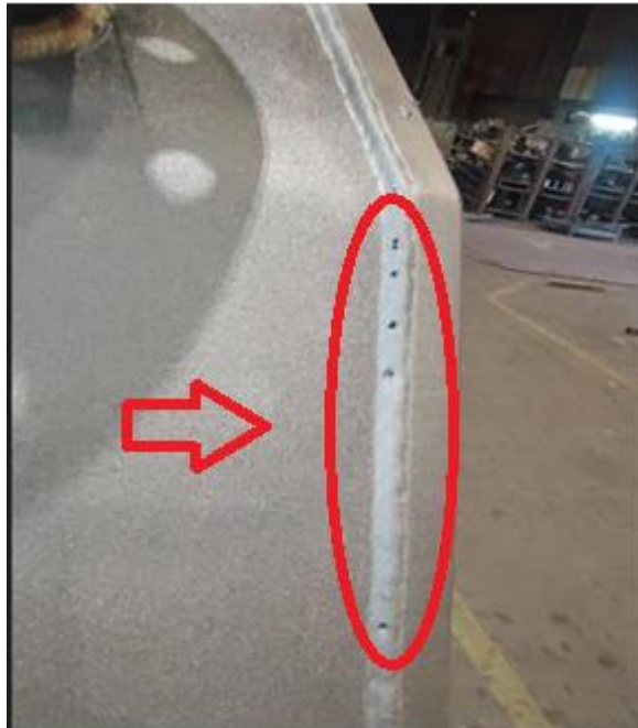
Slika 33. Šupljine na zavaru od kotla
