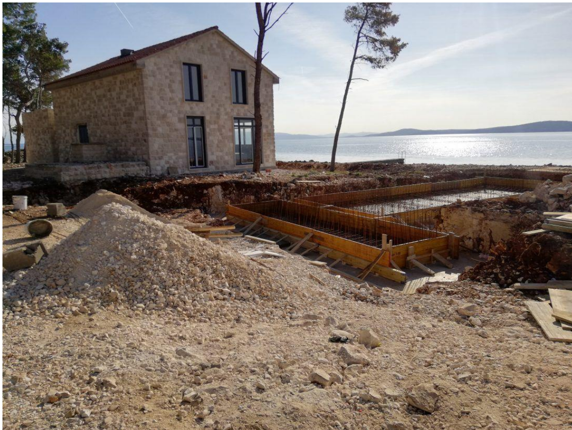
Slika 3. Bespravna gradnja na Čiovu
