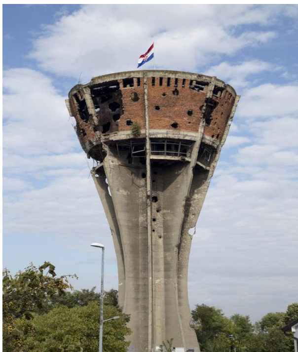
Slika 1. Vukovarski vodotoranj prije obnove
