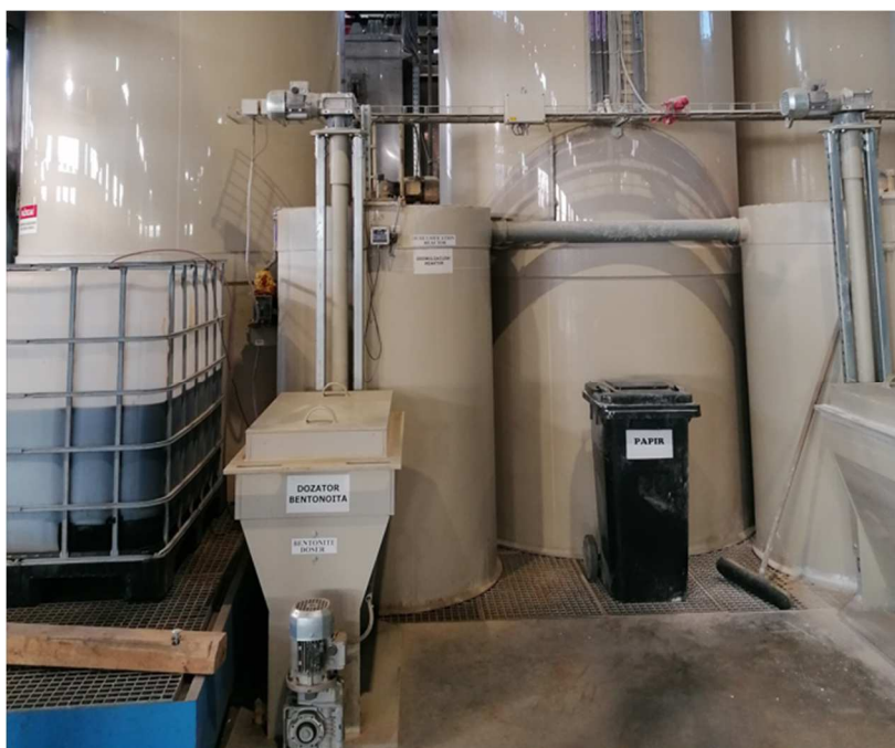
Slika 19. Dozatori kemikalija za pročišćavanje otpadnih voda
