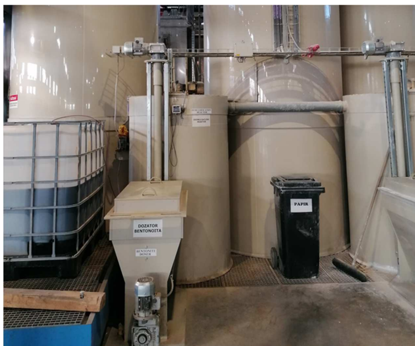
Slika 19. Dozatori kemikalija za pročišćavanje otpadnih voda
