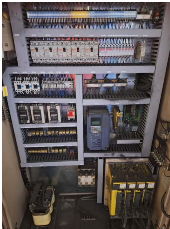
Slika 23. Elektro ormar instalacije, Ferro-Preis d.o.o.
