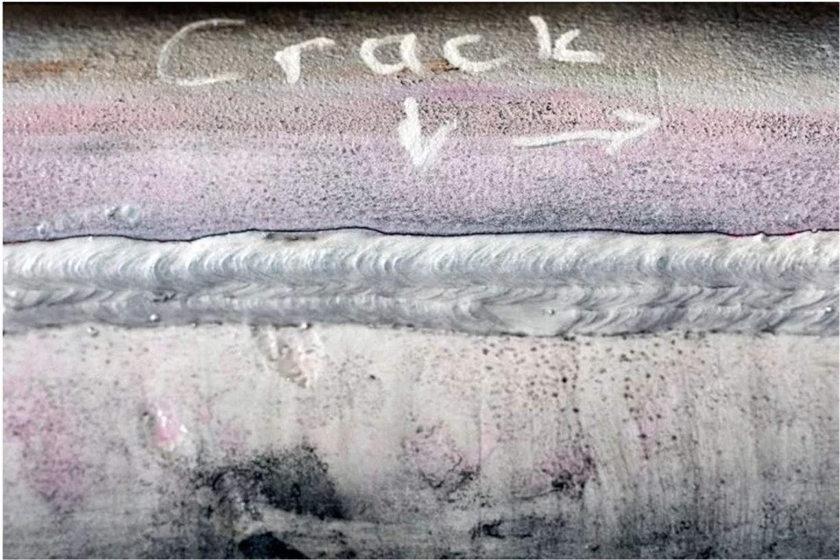
Slika 11. Prikaz pukotine na zavaru
