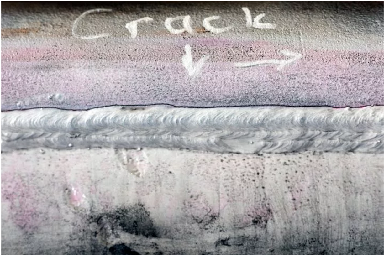
Slika 11. Prikaz pukotine na zavaru
