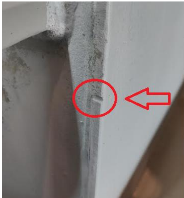
Slika 49. Oštećen materijal na kotlu
