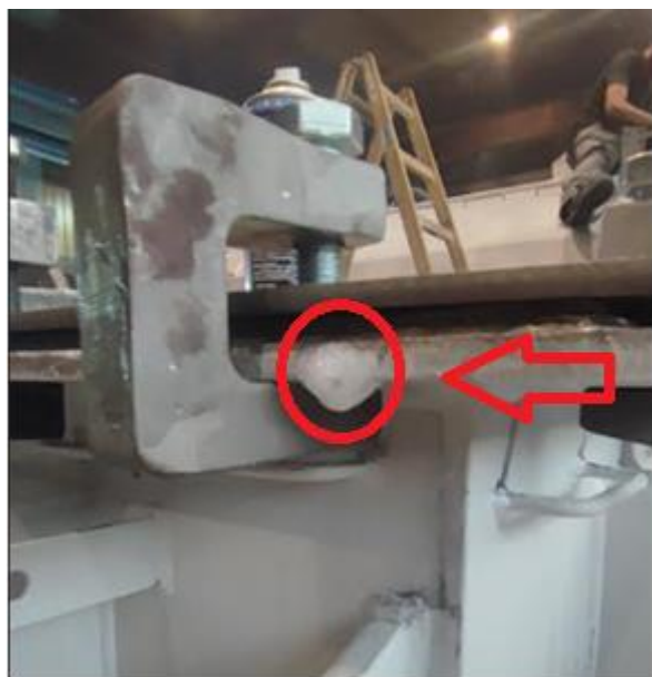
Slika 31. Propuštanje kotla tijekom tlačnog ispitivanja
