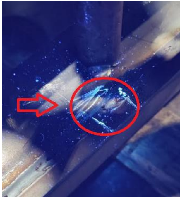
Slika 44. Treće propuštanje kotla
