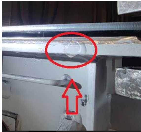
Slika 56. Prvo propuštanje kotla
