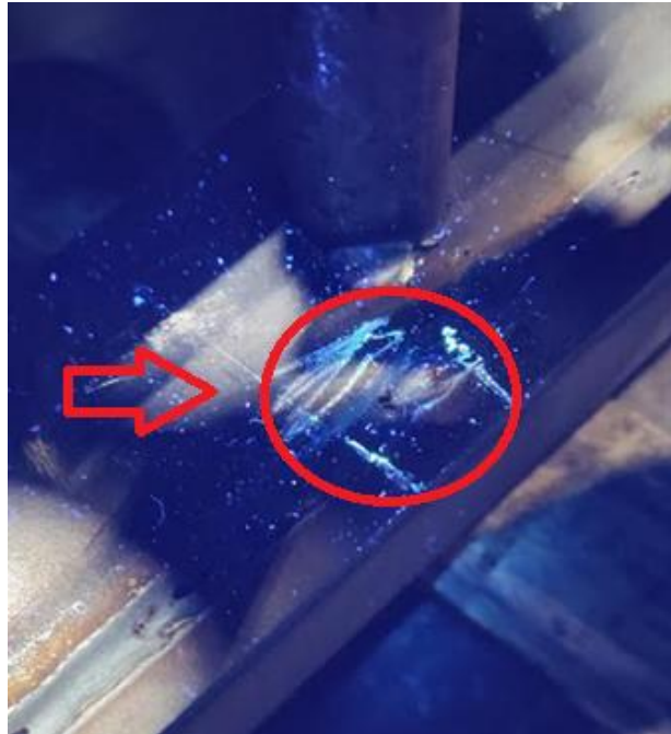
Slika 44. Treće propuštanje kotla
