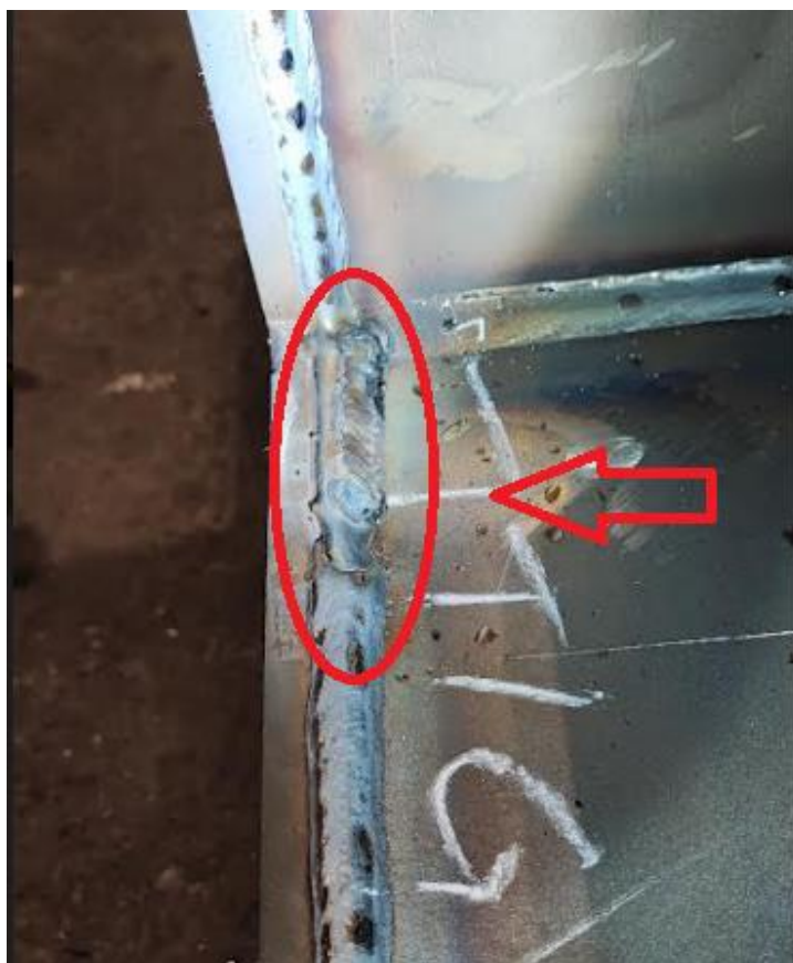
Slika 46. Izgled zavora nakon popravka TIG-om
